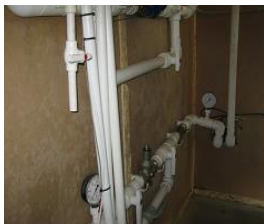
Узел учета воды в павильоне водоочистки
