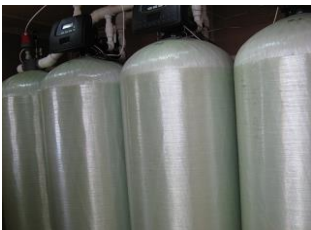
Оборудование очистки воды
