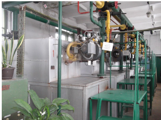
Фото 1.2.2 – котельная д. Лаврово, котлы Братск-1Г
