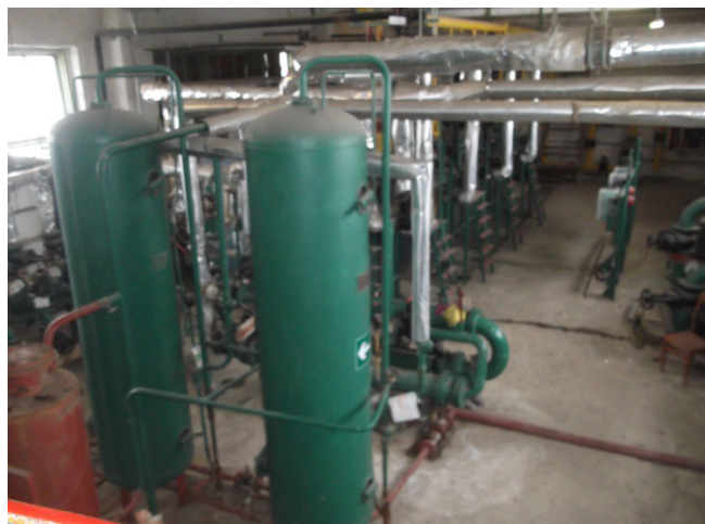
Фото 1.2.8 – котельная с. Григорцево, фильтры ХВО
