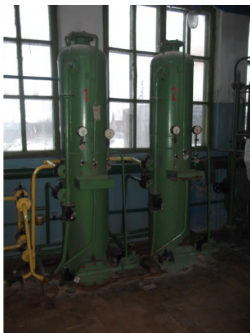
Фото 1.2.7 – котельная д. Лаврово, фильтры ХВО
