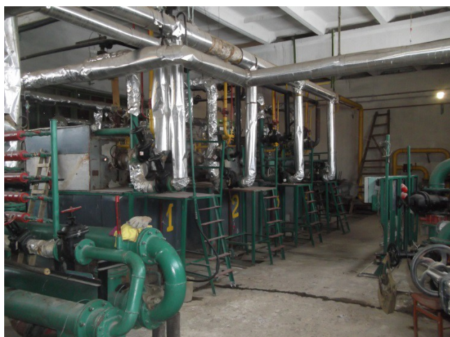
Фото 1.2.9 – котельная с. Григорцево, котлы Братск-1Г
